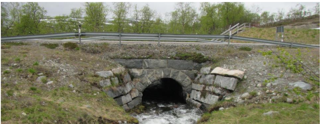
Ahdaskurun silta (kuva: Pentti, M. & Soosalu, L., 2022, Ahdaskurun silta, Kilpisjärvi, Enontekiö: Museosillan kunnossapitosuunnitelma).
